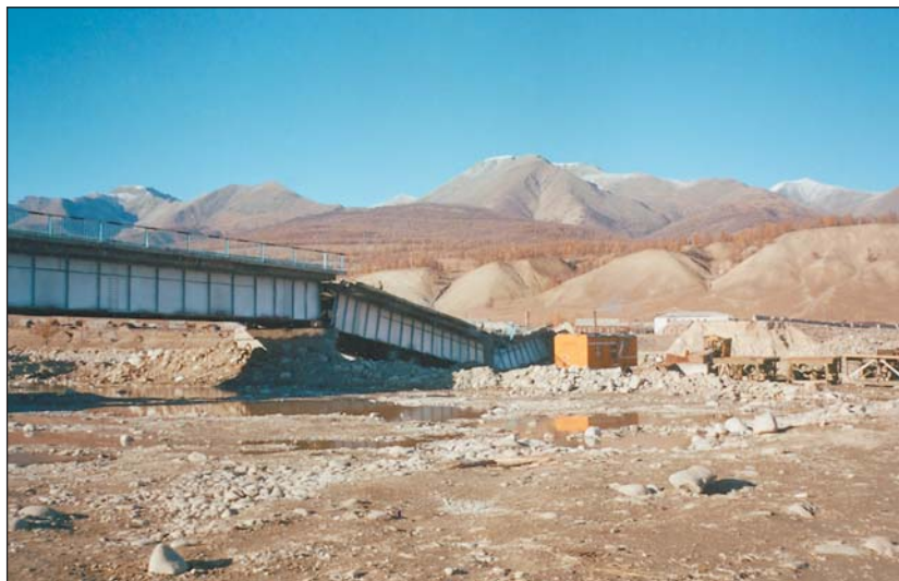
Разрушенный мост через р.Иркут в пос.Монды.
